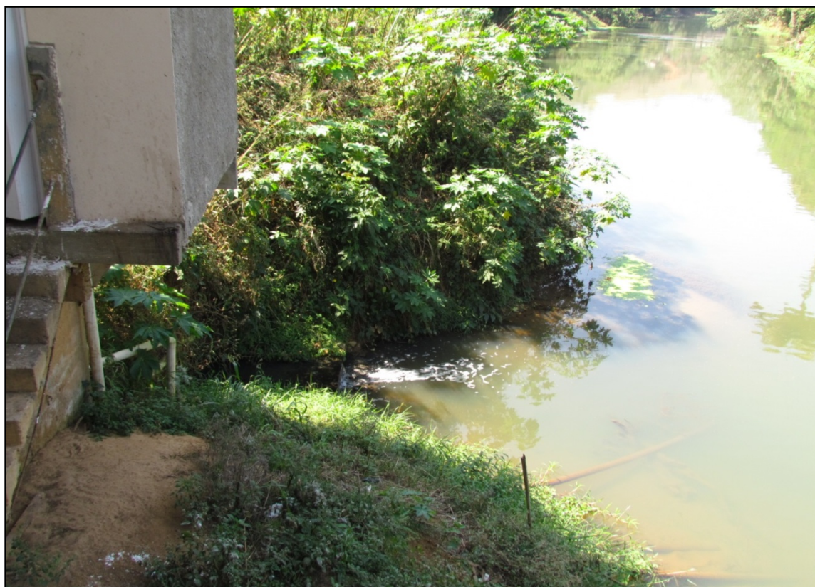
Figura 2-25: Lançamento de esgoto in natura. Fonte: MJ Engenharia (2013)
